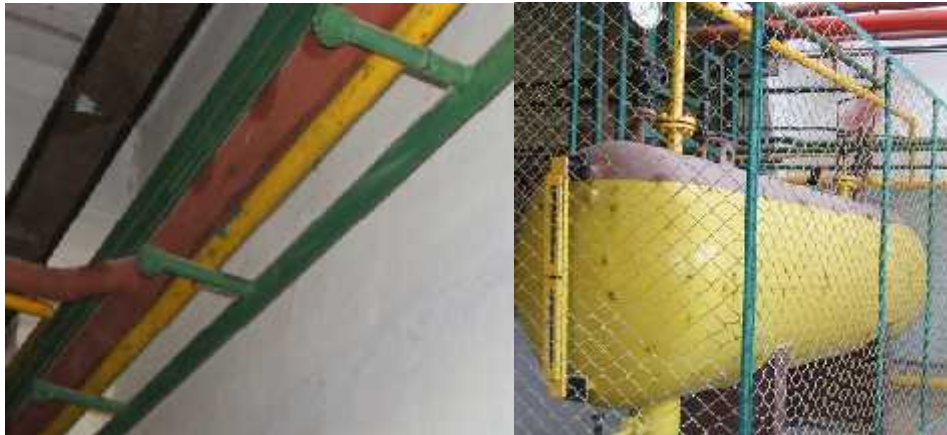
Figura. 2. Deposito de amoníaco e intalación de las boquillas de agua
